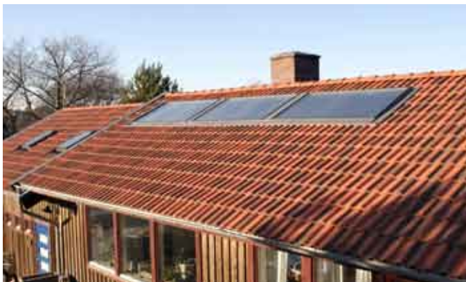
Plana solfångare i nedfällt montage.
